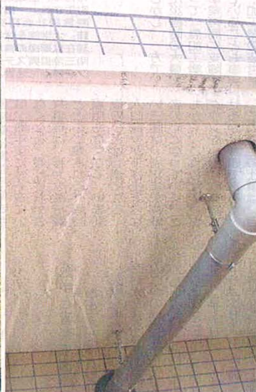
雨水が浸入すると「白華」と呼ばれる液状現象が発生する。白華を放置すると内部の鉄骨がさびて膨張し、コンクリートを壊す「爆裂」が起こる。いすれも建築診断協会提供
