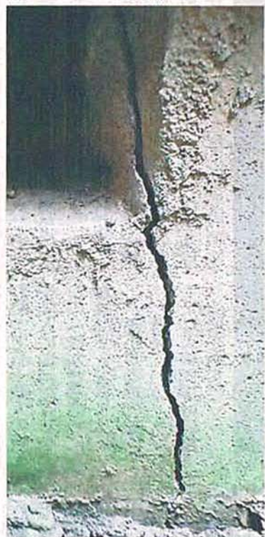
住宅の基礎に入ったひび割れ—さくら事務所提供
